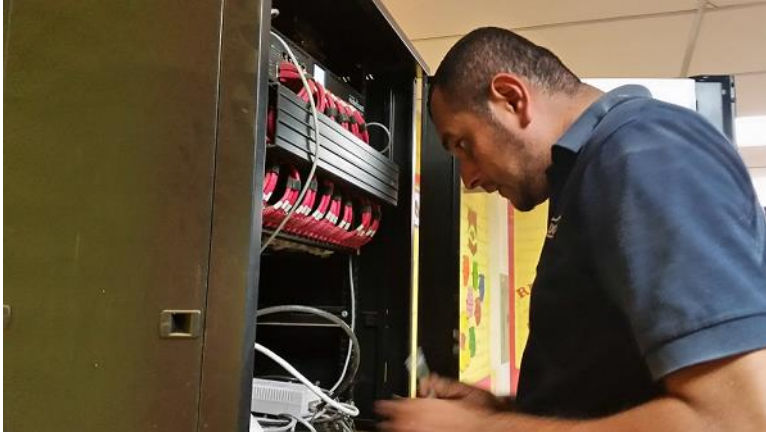
Ilustración 10: Configuración de router y equipo de red 10/04/2019
